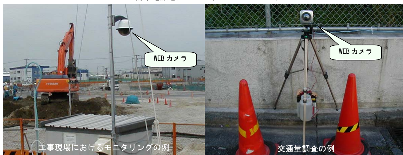
WEBカメラを用いたモニタリングの例
